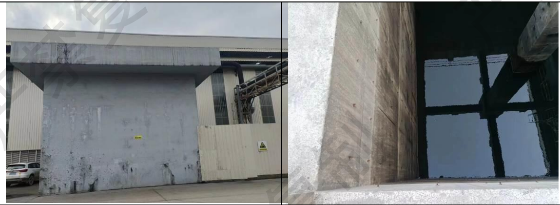
特钢公司已建的 480m 3 事故应急池
